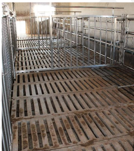
Figura 46. Fessurato in cemento (non idoneo)
